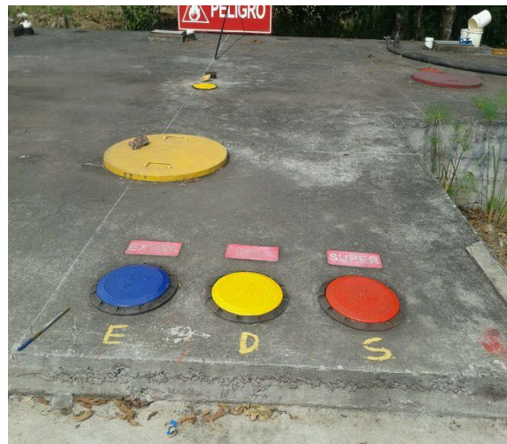
Bocas de llenado (Anexo 9)
