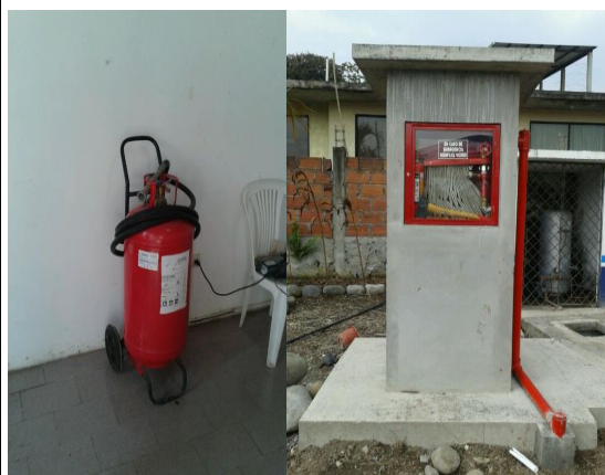
Extintor satelital y Red Hídrica (Anexo 7)
